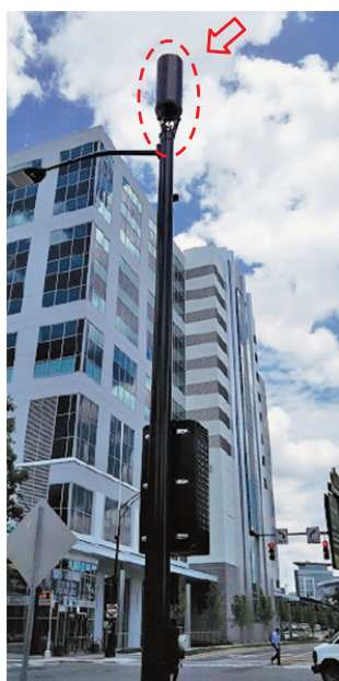
写真 2 アンテナ設置例
